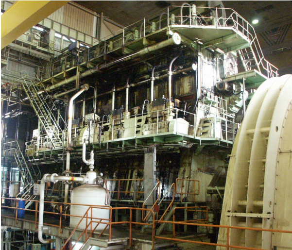
FIGURE 7.16 – Un moteur Diesel Sulzer RTA76 à neuf cylindres dégageant 25 MW de puissance à 95 rpm. Cet exemplaire est installé ici dans une usine mais le modèle est couramment utilisé pour propulser des navires marchands.
