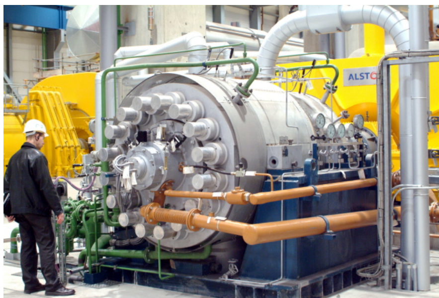
FIGURE 9.2 – Une pompe du fabricant KSB menant 2500 t/h d'eau à 350 bar dans une centrale à vapeur. Les pompes à liquide sont usuellement alimentées par un moteur électrique, mais ce modèle est alimenté mécaniquement par la turbine et doit ainsi fonctionner sur une plus grande plage de vitesses. Sa puissance maximale est de 38 MW ; la puissance de la turbine entraînée dépasse 800 MW.
